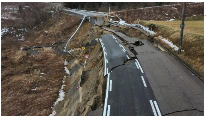
崩落した国道359号（小矢部市）
