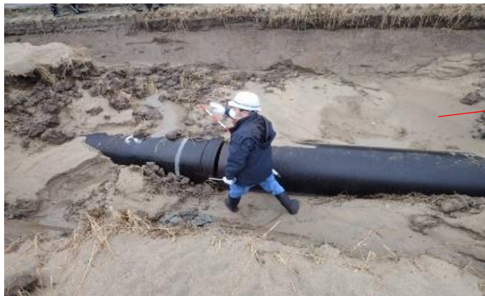
液状化による管水路・農道の被災（氷見市）
