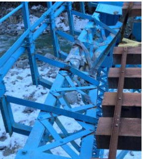
鐘釣橋の落石による被害
