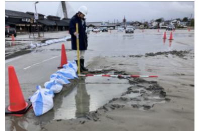
ひみ番屋街駐車場の液状化
