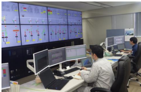
監視室（発電制御担当）
