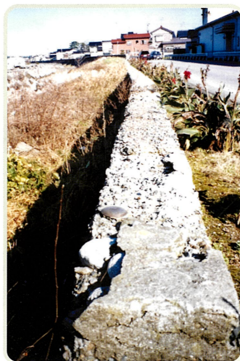
● 老朽化した護岸 経田海岸（魚津市）
