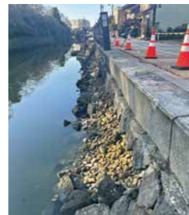
写真1 高岡古城公園 池の端（護岸崩壊）
