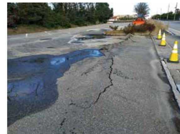
写真2 射水市奈呉の江西公園（舗装隆起）
