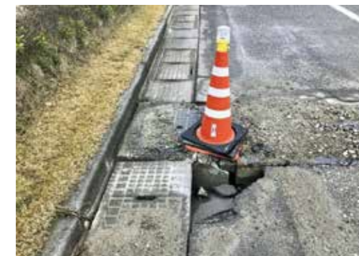
写真4 氷見市比美乃江公園（側溝破壊）
