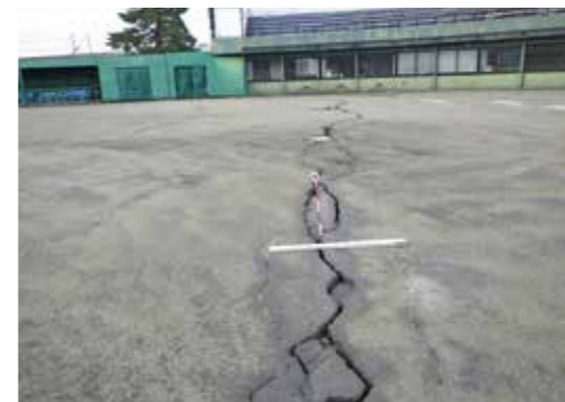
写真3 滑川運動公園（グラウンドひび割れ）
