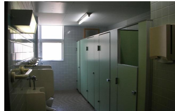
狭隘なトイレ（身体障害者用トイレがない）
