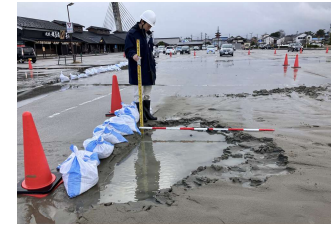
ひみ番屋街駐車場の液状化
