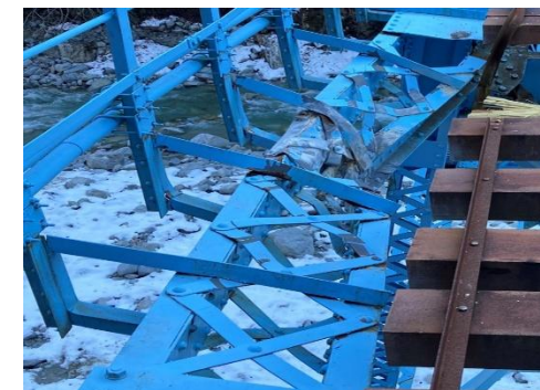
黒部峡谷鉄道「鐘釣橋」の落石被害
