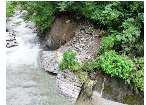
7月下旬の大雨により被災した護岸
