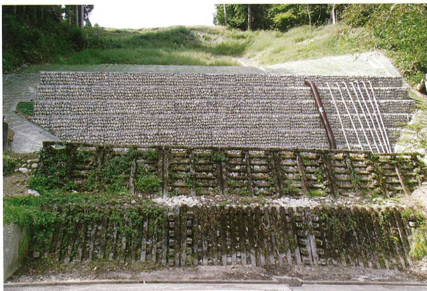
(株)辻建設施工の「主要地方道高岡羽咋線県単独災害防除擁壁工 工事」
