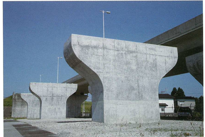
㈱伊原組施工の「主要地方道富山立山公園線道路総合交付金 藤木高架橋下部工工事」
