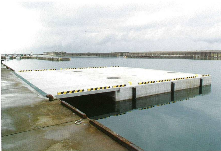
五本建設㈱施工の「伏木富山港（富山地区）港湾総合交付金 岩瀬船だまり棧橋整備工事」
