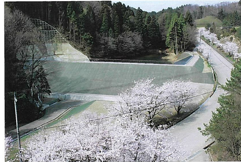
梅本建設工業(株)施工の「県営農村地域防災減災事業安居地区安居古堤堤体改修工事」
