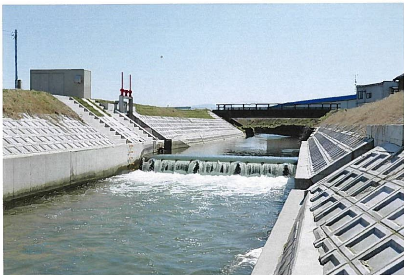
(株)野手組施工の「河川応急五ヶ村地区五ヶ村取水工改築工事」
