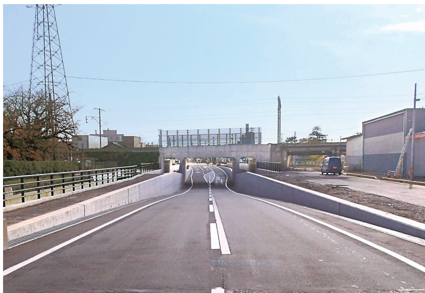
射水工業(株)施工の「都市計画道路二口北野線街路総合交付金道路改良擁壁工第1工区工事」
