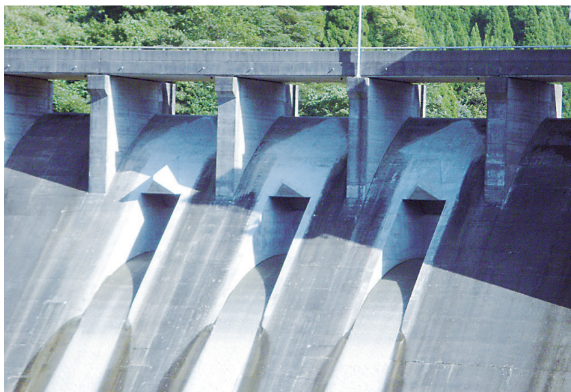
佐藤工業・酒井建設共同企業体施工の「熊野川ダム河川総合交付金常用洪水吐改良工事」
