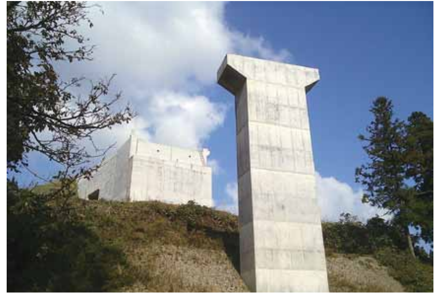
(株)婦中興業施工の「一般国道471号道路総合交付金（改築・国道）枋折橋下部工P1橋脚工事」
