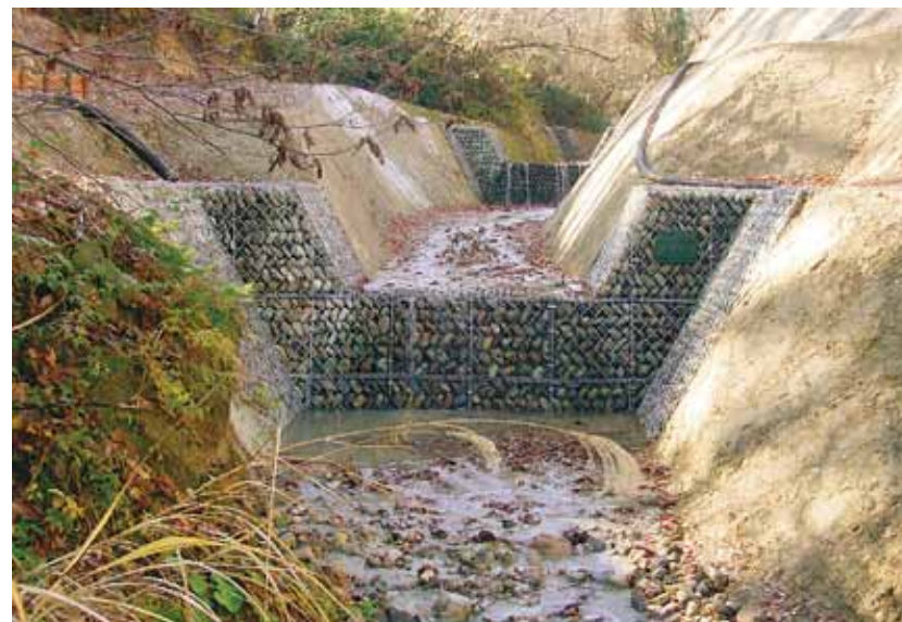
(株)森組施工の「地すべり対策福光地区上小二又堰堤工第3工区工事」
