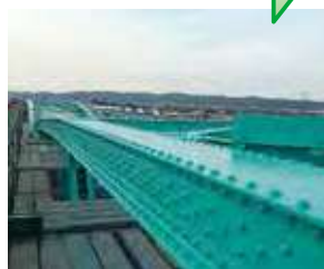
鋼橋の防食機能維持
