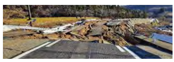
地震により崩落した国道359号
