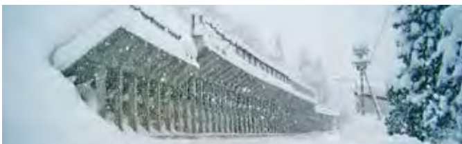
雪崩対策施設
