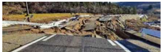
地震により崩落した国道359号
