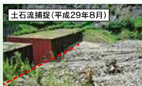
土石流捕捉（平成29年8月）
