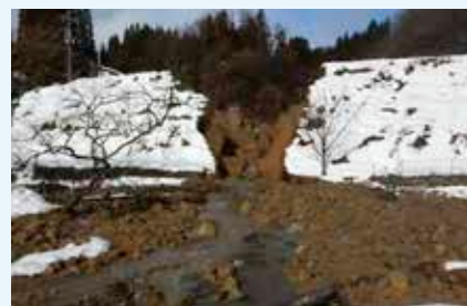
破堤したため池（豆田池 氷見市）
