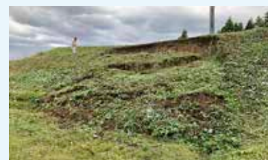
災害発生状況 (法面崩壊)
