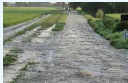
溢水被害状況 (針山口六ヶ用水路 高岡市)
