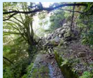
法面崩壊による閉塞被害 (立山町吉原用水)
