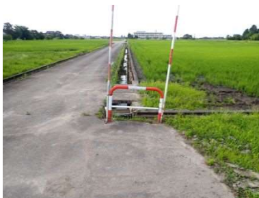
道路が狭小となる箇所への対策
