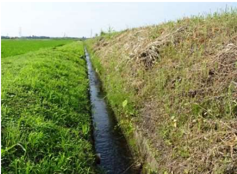
浸食土砂により水路天端が消失
