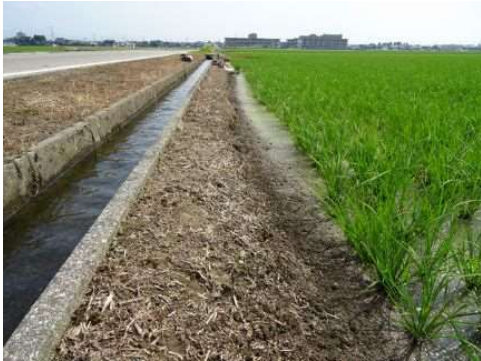
浸食により水路溝畔が狭くなった状況
