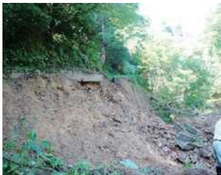
【土砂侵食により崩落した用水路】
