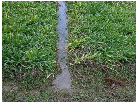
溝が連結されていない
