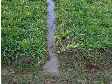
溝が連結されていない
