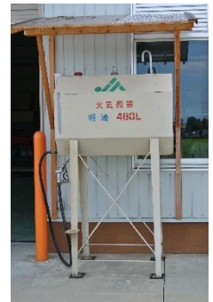
写真：防油堤がない
