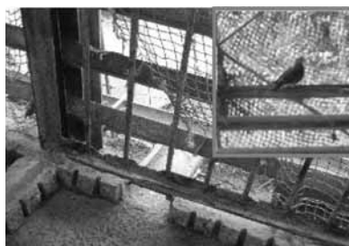
防鳥ネットの破損と鳩の侵入
