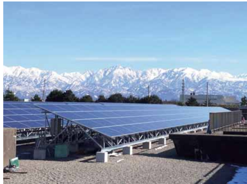
神通川浄水場太陽光発電所
