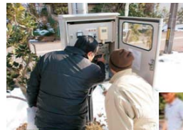
消雪設備の節水
