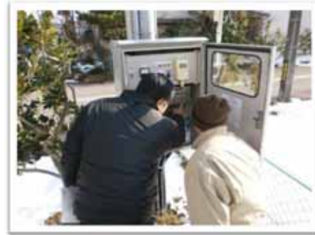
制御盤の設定変更の様子
