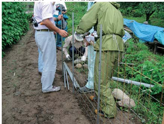
②中間支柱を挿し、ワイヤーメッシュを設置 中間支柱は1m間隔で設置
