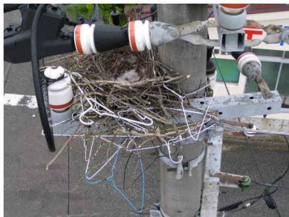
電柱に作られた巣（北陸電力(株)提供）
