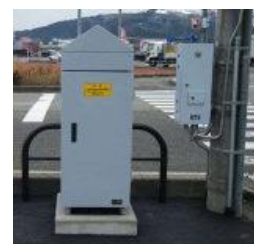
信号機電源付加装置
