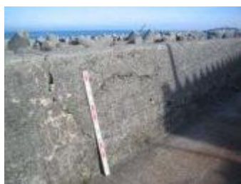
護岸老朽化状況
