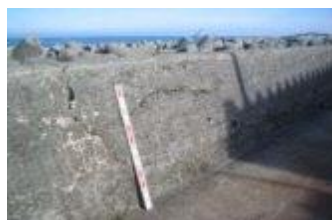
護岸老朽化状況
