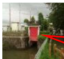
老朽化状況（松川水門）
