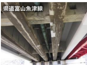
今川橋の損傷(富山)
