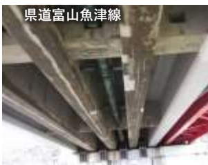
今川橋の損傷(富山)
